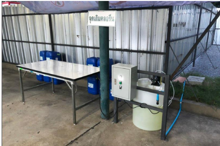
ติดตั้งจุดเติม คลอรีนฆ่าเชื้อโรค น้ำทิ้งก่อนระบาย ออกสู่สาธารณะ
