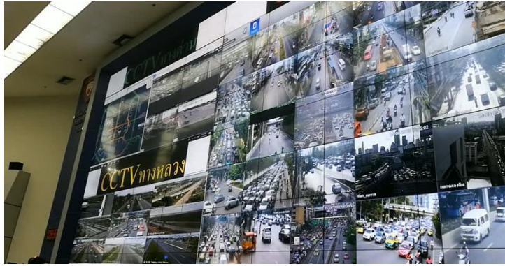
รูปภาพที่ ๑.๒ ศูนย์ควบคุมสั่งการและแก้ไขปัญหาการจราจร กองบังคับการตำรวจจราจร (บก.จร.) ถนนวิภาวดีรังสิต
